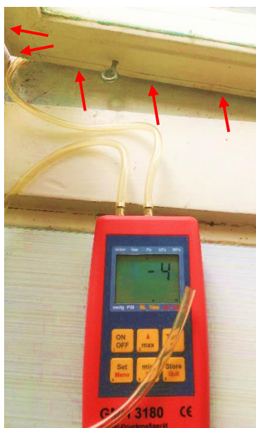
Fig 10. Mätning av undertryck i fönsterspringa. Gör inte som på fotot utan täta fönsterspringan hela vägen!
